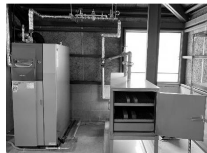
図4 水蒸気発生装置及び蒸煮釜
