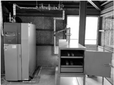
図4 水蒸気発生装置及び蒸煮釜
