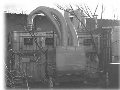
写真2 木材乾燥機(奥側)と精油回収装置(手前)
